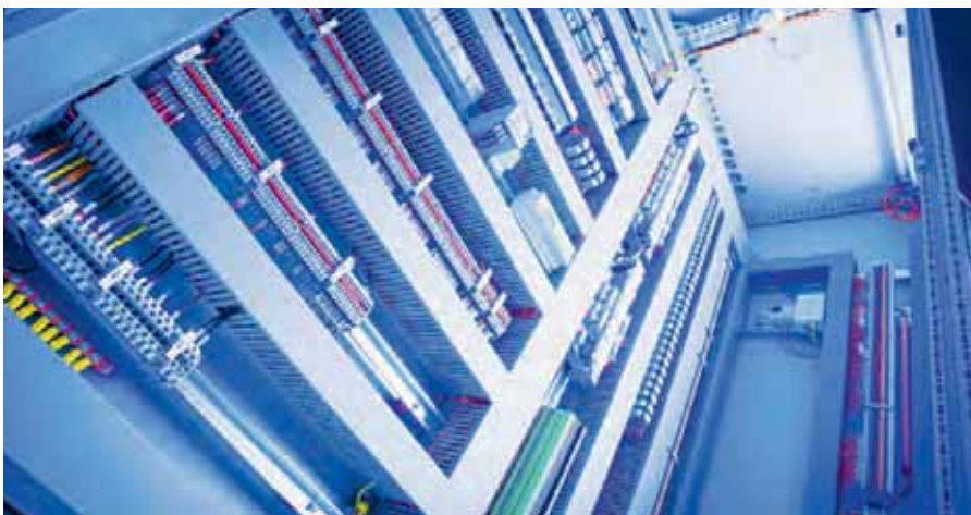
▼ WKW Malga Bissina – Elektrische Ausrüstung
