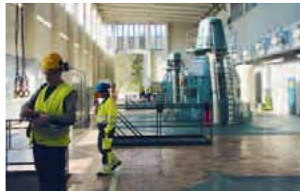
■ Maschinenhaus im WKW Bjurfors Övre
