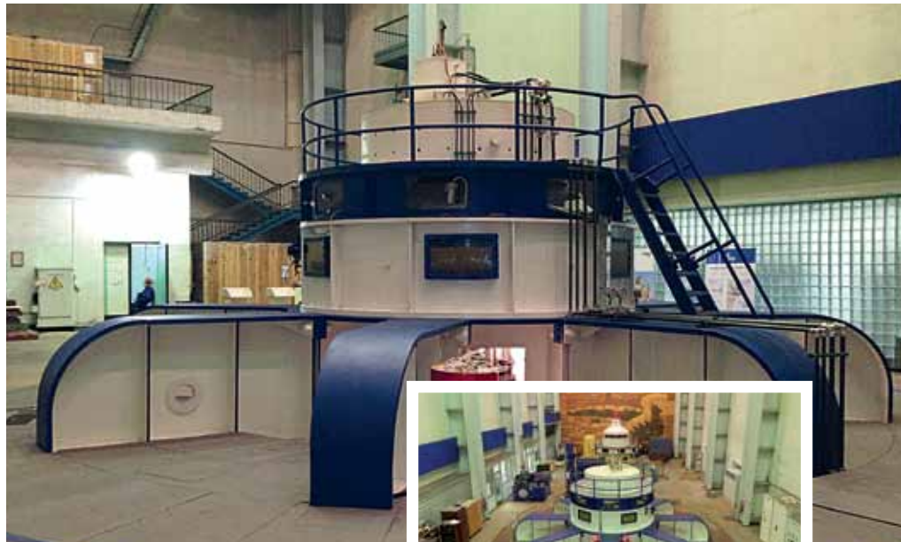
▲ Von ANDRITZ HYDRO gelieferte Maschine 1
