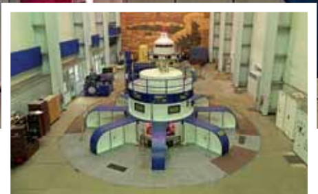
▲ Maschinen 1 und 2 im Kraftwerk Iovskaya
