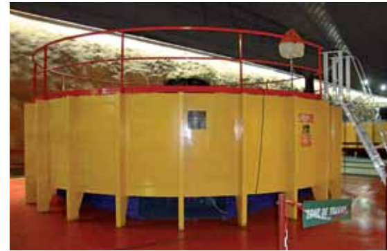
▲ Maschine 2 des Wasserkraftwerks
