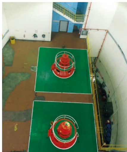
Sala de máquinas de la CH Centroamérica
