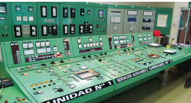
Antiguo sistema de control existente en la CH Carlos Fonseca
