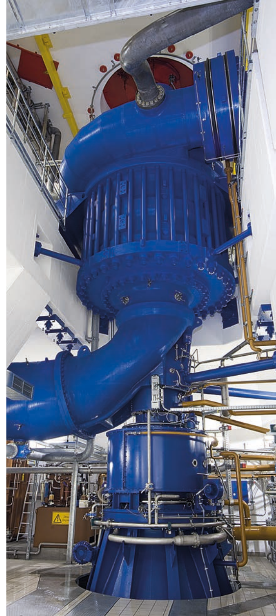
Pumpturbineneinheit mit vier Stufen
