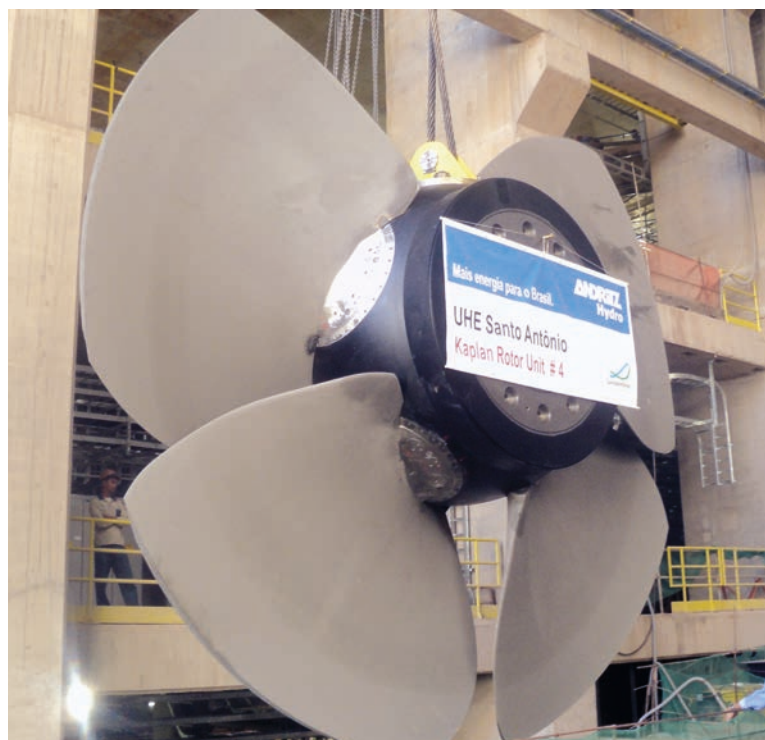
Trabajos de montaje de turbinas Bulbo en la CH Santo Antônio, Brasil
