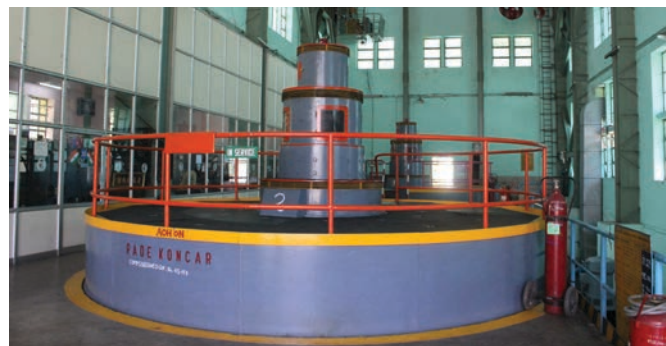
Sala de máquinas
