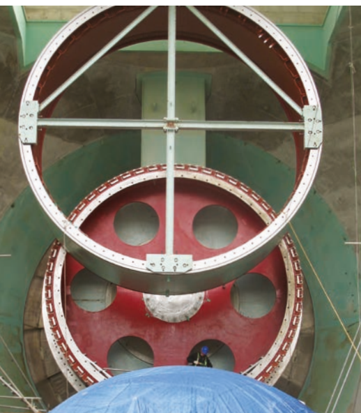
Montaje de partes de la turbina Bulbo en la CH Sihwa, Corea del Sur
